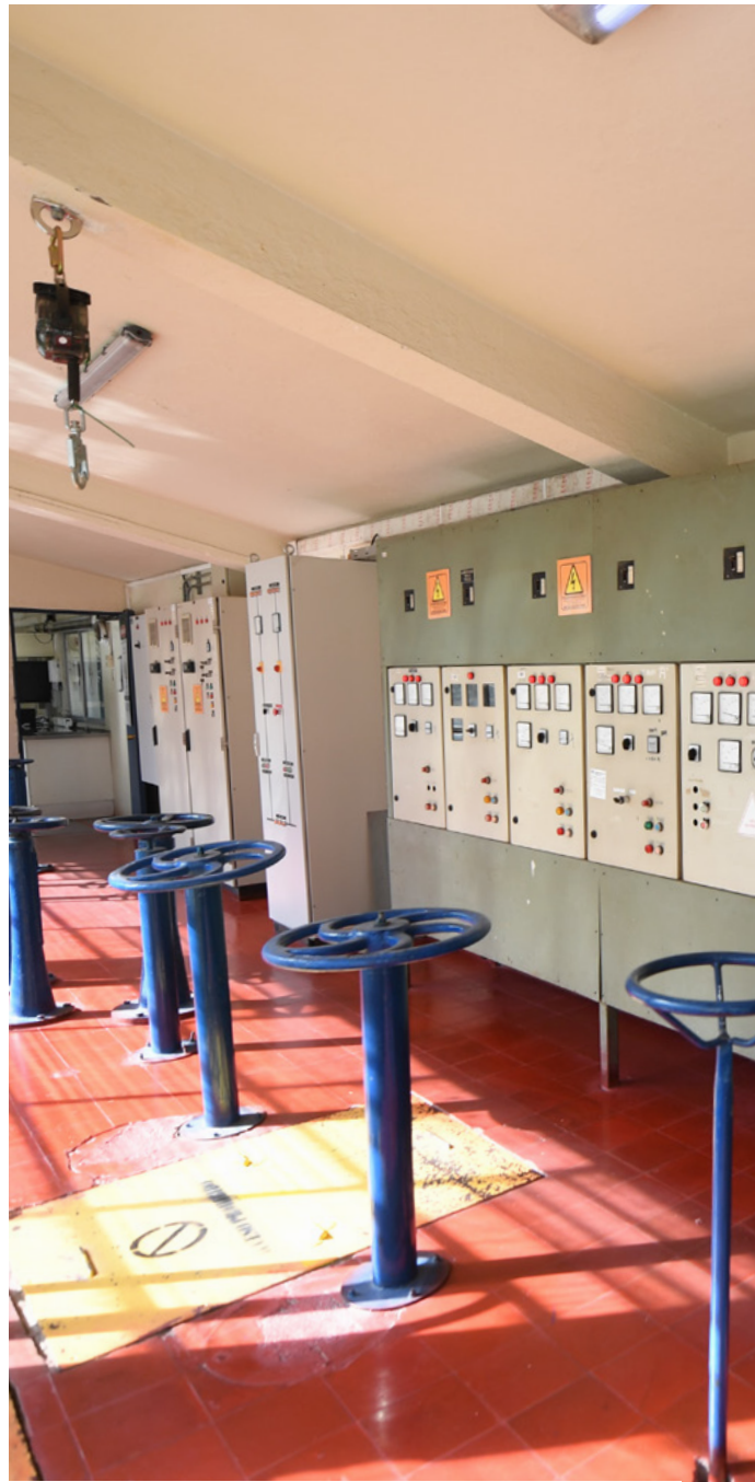
PLANTA AGUA POTABLE ARRAYÁN, LO BARNECHEA ➤
